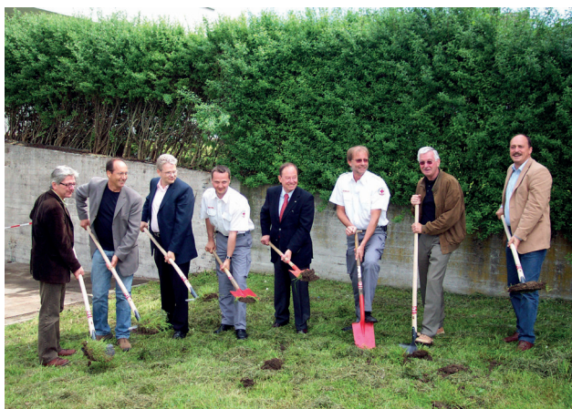
Nach zahlreichen Gesprächen und Verhandlungen wurde Lochau zur Standortgemeinde für den neuen Rotkreuz-Stützpunkt im Leiblachtal – Spatenstich und Bau.
